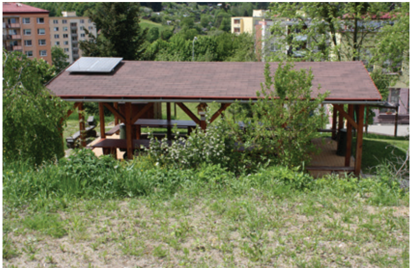
Solárny panel na streche prírodnej učebne v ZŠ Rokytнице vo Vsetíne je využívaný na výrobu elektriny pre ponorné čerpadlo v zbernej podzemnej nádrži dažďovej vody.
